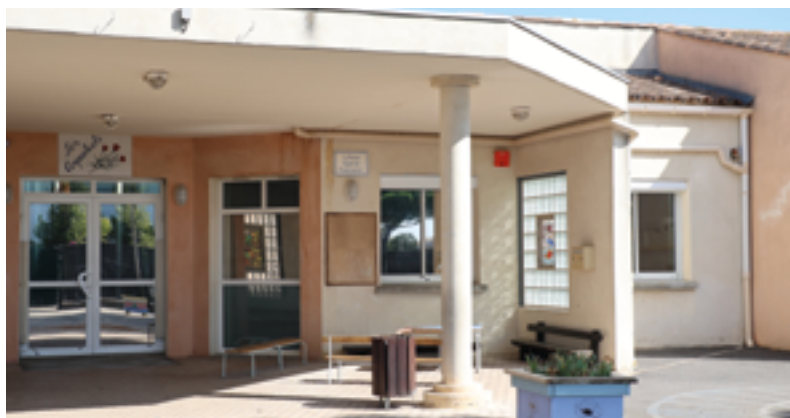
Étanchéité du préau
