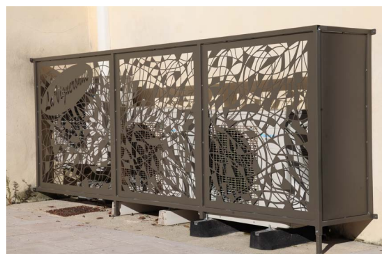
• Installation d'un mobilier urbain personnalisé sur le parvis de la Vigneronne (protection moteurs climatiseurs) – Novembre 2018
