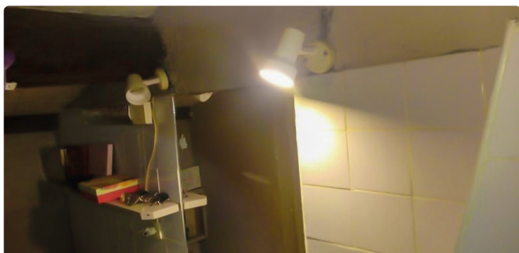
Luminaire pas destiné à la salle de bain ne respecte pas la norme ip44
