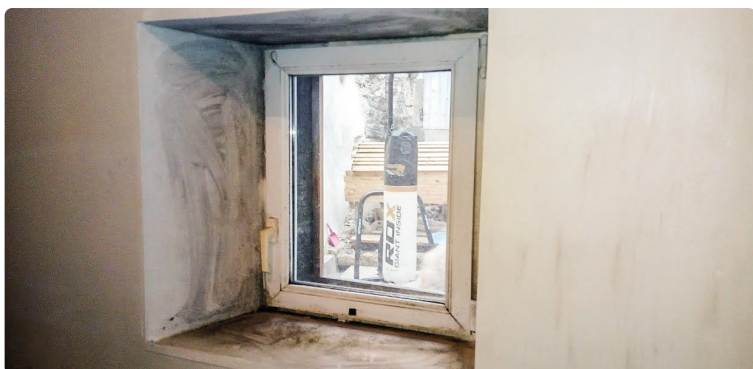
Menuiserie en pvc avec infiltration d'eau
