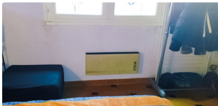
Chauffage ne permettant pas de garantir une température de 19°C
